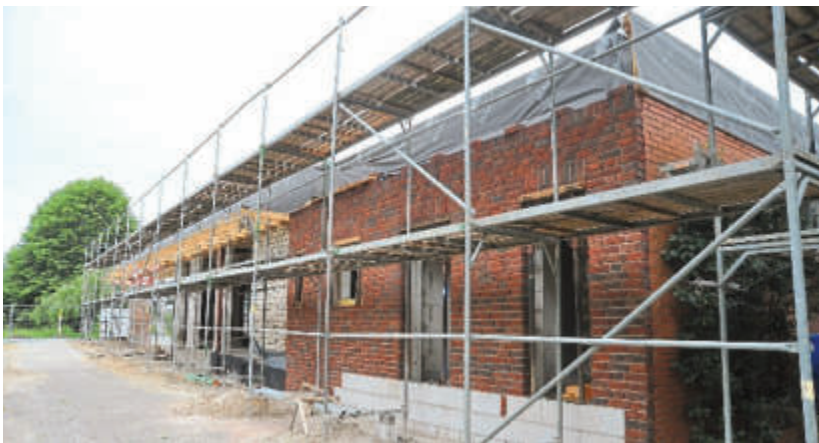
Dieses Bild der Dorfladenbaustelle in Schale stammt aus dem Sommer. Fenster und Türen sind inzwischen drin, der Innenausbau geht gut voran. Ab dem kommenden Wochenende wird auch an der Außenfassade weitergebaut. Das machen – wie so vieles – vor allem Handwerker aus dem Dorf ehrenamtlich. Foto: Anke Being/Archiv
